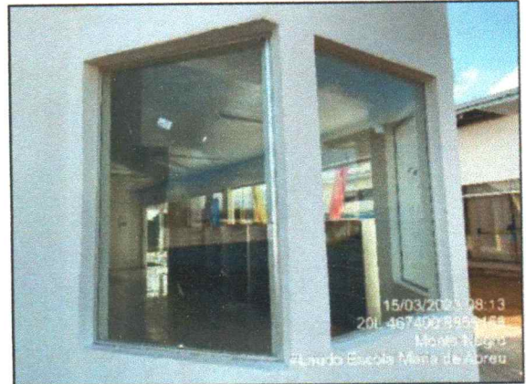
Figura 18 – Vidros com fixação adequada
