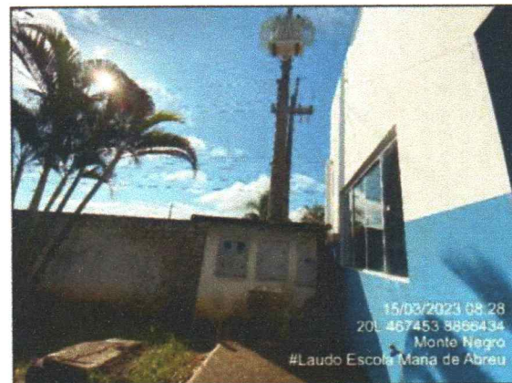
Figura 7 – Subestação de energia elétrica
