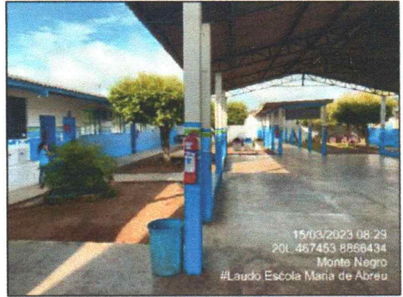
Figura 4 – Extintores de Combate a incêndio
