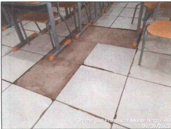
Figura 27: Piso cerâmico se soltando em sala de aula.
