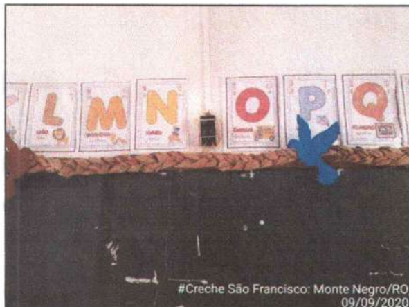
Figura 12: Disjuntores utilizados de maneira inadequada nas salas de aula.
