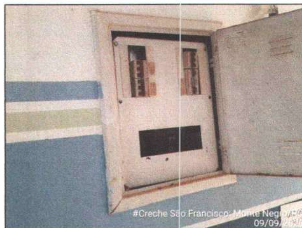
Figura 15: Quadro de Circuitos com fechamento inadequado.
