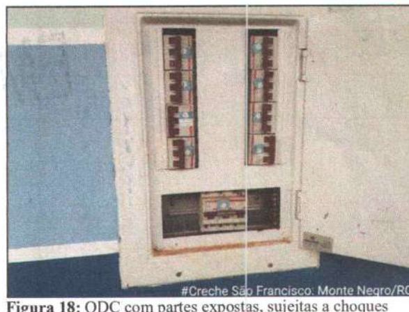
Figura 18: QDC com partes expostas, sujeitas a choques elétricos.
