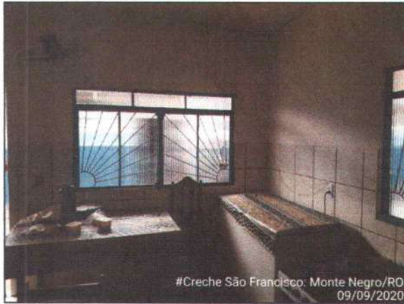
Figura 19: Ventilador instalado de maneira inapropriada.
