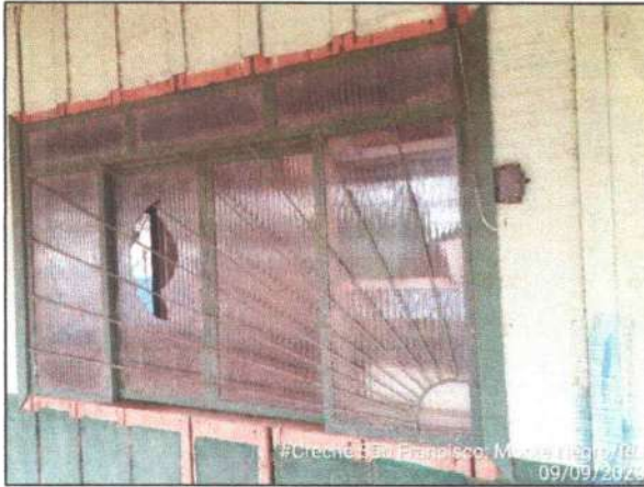
Figura 23: Vidro quebrado e fiação exposta.
