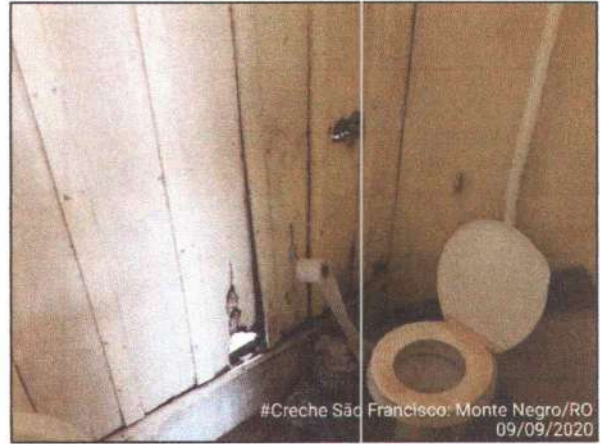
Figura 24: Sanitário com paredes em madeira em péssimo estado de conservação.
