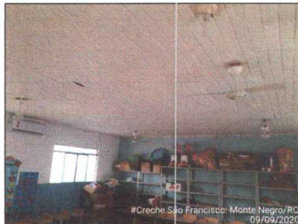
Figura 13: Ventiladores e lâmpadas com defeito.
