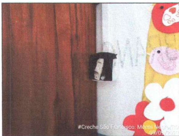
Figura 17: Interruptor instalado em desacordo com a segurança.
