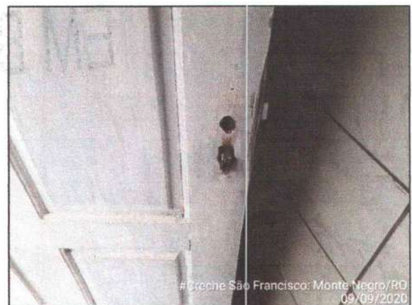
Figura 32: Fechadura e maçaneta de porta com defeito.
