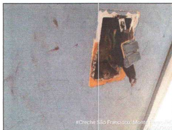
Figura 11: Cabos elétricos energizados expostos de maneira inadequada nas salas de aula.
