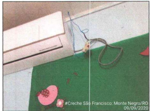
Figura 20: Aparelho de ar condicionado com fiação exposta
