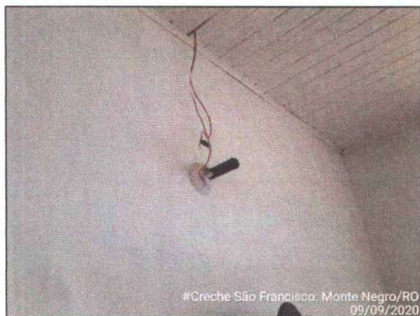
Figura 14: Fiação elétrica exposta dos ventiladores.
