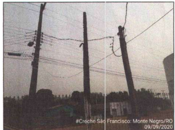
Figura 30: Poste de energia – Entrada/Medidor.
