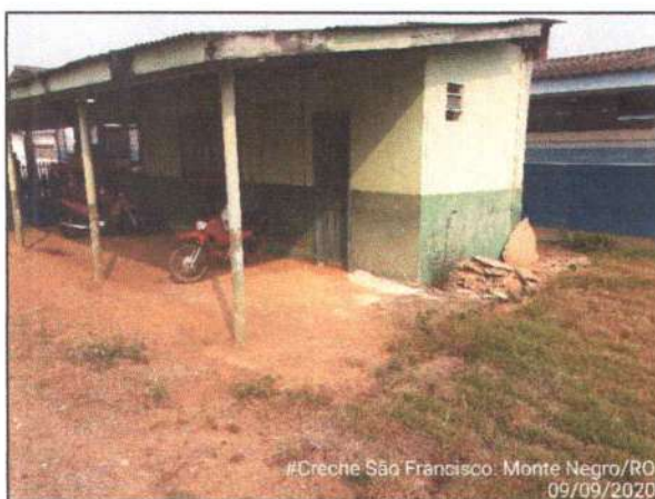
Figura 21: Edificação em madeira em péssimo estado de conservação.
