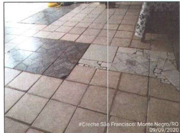
Figura 28: Piso cerâmico necessitando de reparos.
