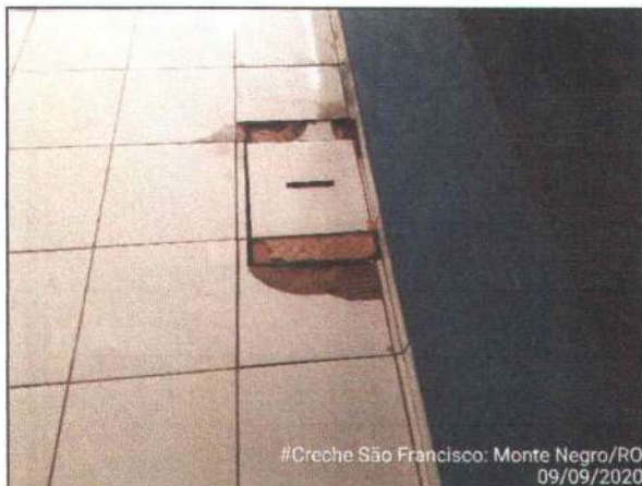
Figura 31: Piso Cerâmico com defeito.
