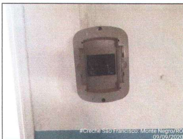
Figura 10: Disjuntores utilizados com interruptores de lâmpadas e ventiladores nas salas de aulas.
