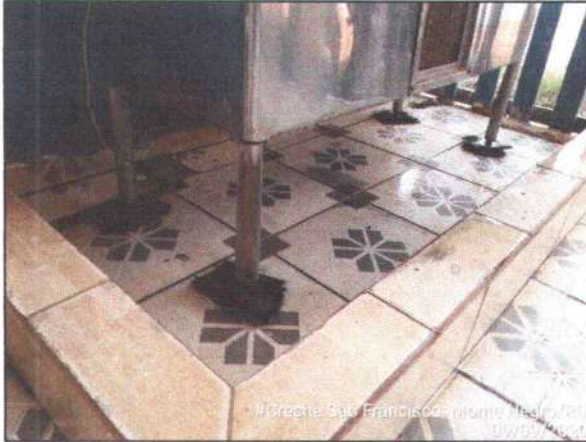
Figura 4: Extravassão inadequada de água no bebedouro.
