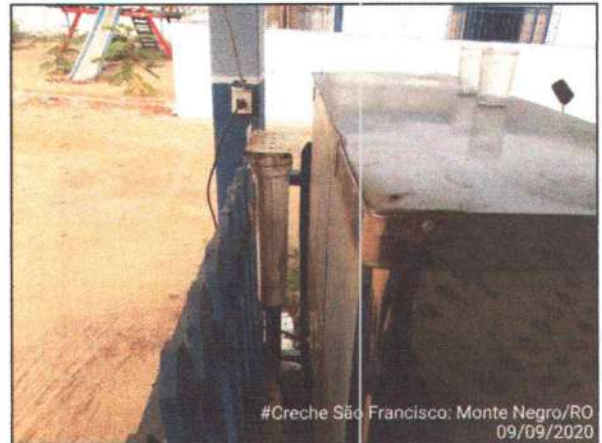
Figura 5: Instalação elétrica inadequada no bebedouro.
