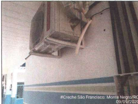
Figura 6: Ar condicionado necessitando de drenos d'água.
