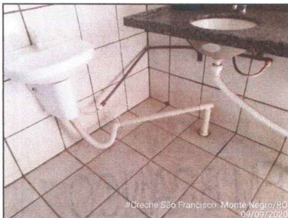
Figura 2: Instalações hidrossanitárias do banheiro de alunos.
