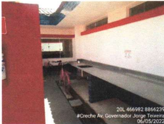
Figura 15: Área de Tanque em perfeito estado de funcionalidade
