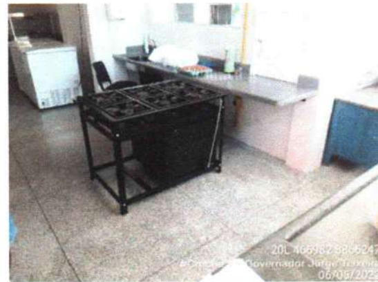
Figura 14: Cozinha arejada, porém com Botija interna, sendo necessária a instalação externa.
