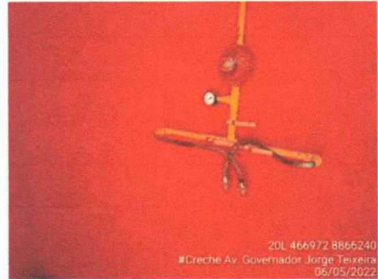
Figura 16: Registro de Gás com Abrigo externo, sendo necessária a transferência das botijas internas para este local.
