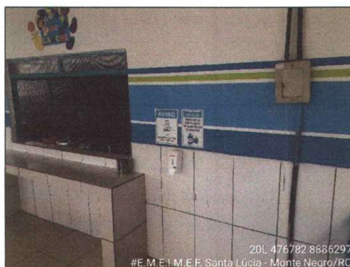
Figura 10: Disjuntores instalados em altura adequada - Refeitório
