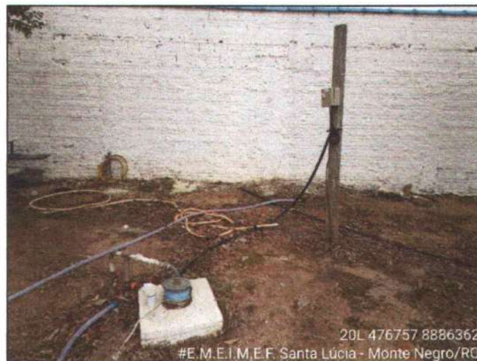
Figura 5: Poço semi-artesiano com Caixa de Disjuntor com livre acesso
