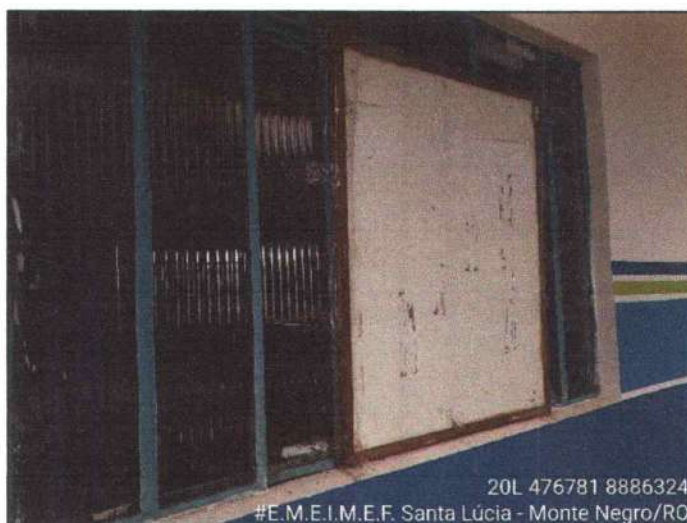
Figura 14: Vidro de janela Substituído por madeira – Necessita-se de reparos
