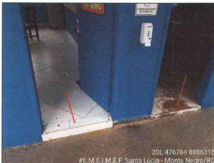
Figura 21: Acesso às salas de Aula necessitando de Rampas de acessibilidade
